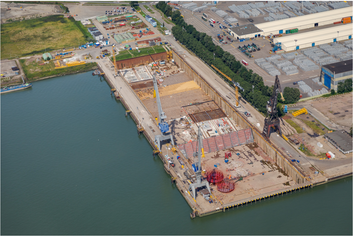
Foto Rijkswaterstaat. Het Damen Verolme dok vanuit de lucht met boven- en onderin de tunneldelen in aanbouw
