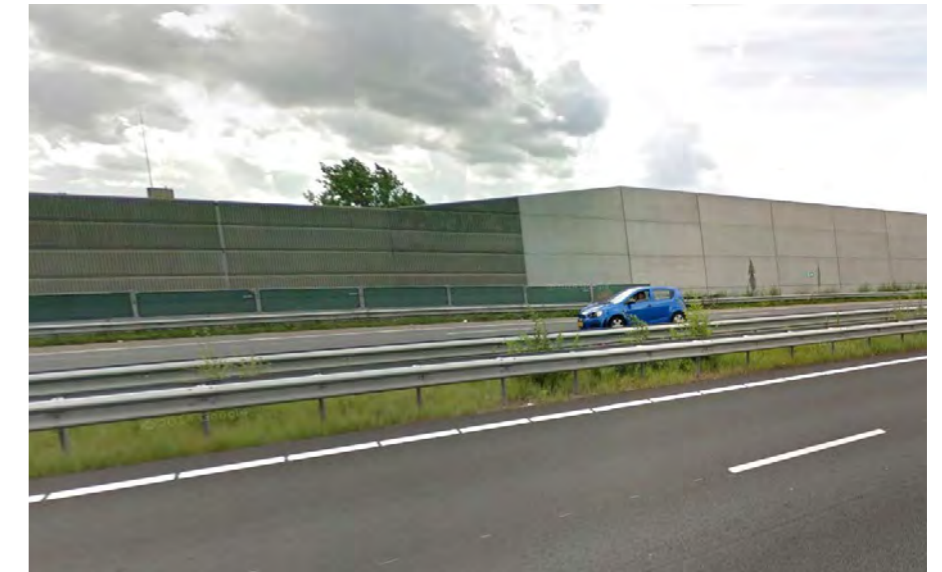
Bestaande schermen A20 / Kethelplein
