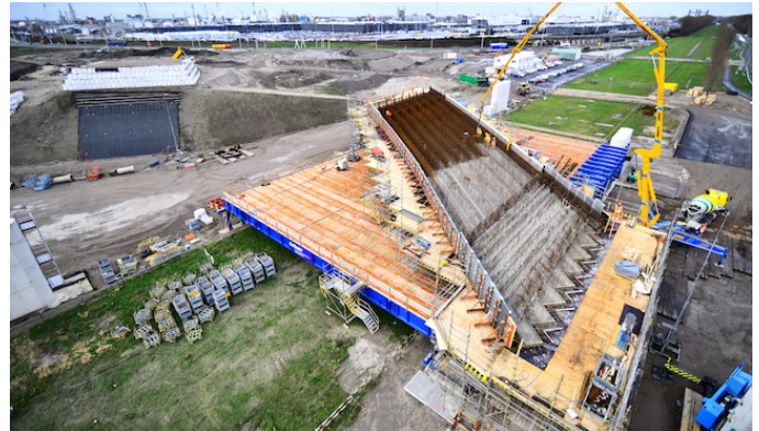
Afbeelding 1 Tafelconstructie met daarop betonnen dek bij Droespolderweg de fly-overs (zie afbeelding 3). De pijlers maken we in vier stappen (zie afbeelding 2):
